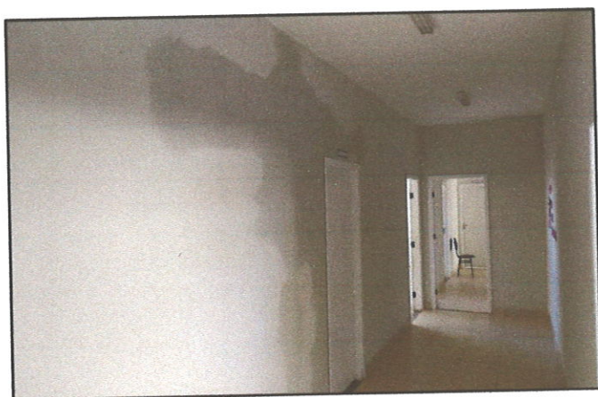
FIGURA 03 - Parede com infiltração
